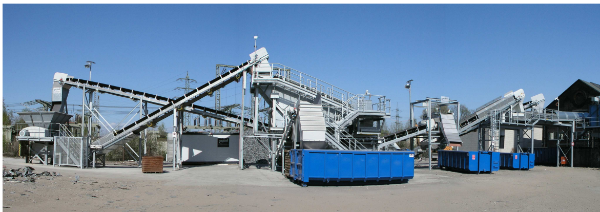
Außenbereich der Zerkleinerungs- u. Trenntechnik
